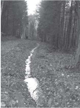
Teilsanierung Oberflächenwasserfassung nach Fertigstellung im Jahr 2008: Entwässerungsgraben im Süden – Graben mit Raubbett ausgebaut
