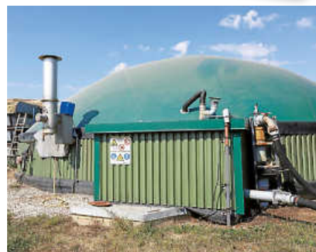
Biogasanlage mit grünem Kuppeldach. In der Anlage auf dem Hof von Markus Bauer vergären Gülle und nachwachsende Rohstoffe wie beispielsweise Mais zu Biogas.
